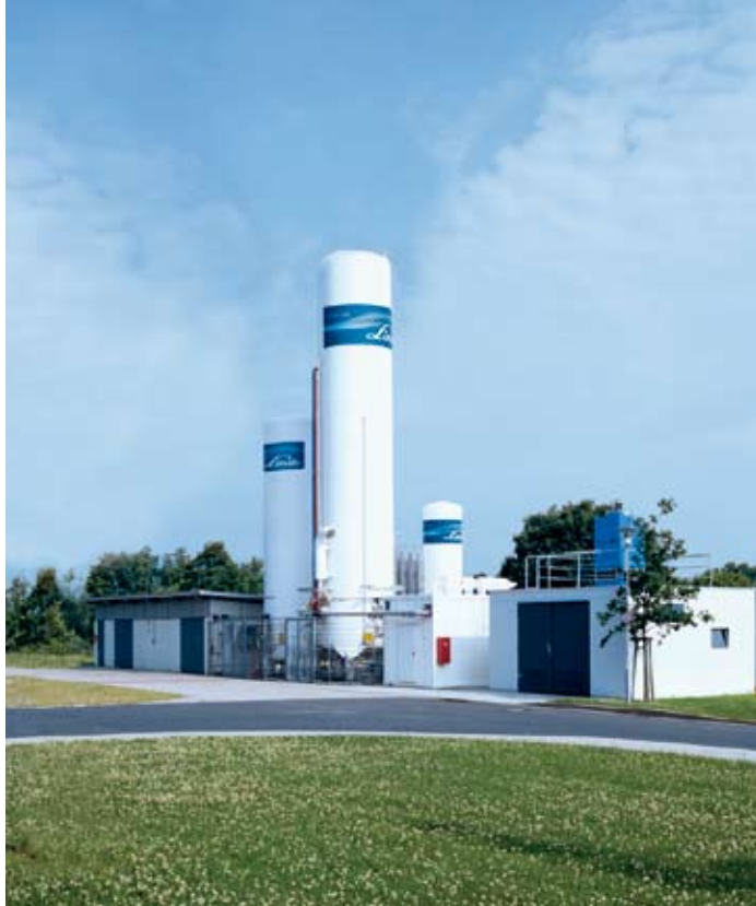
On-site-Versorgung mit dem ECOVAR®-System.
